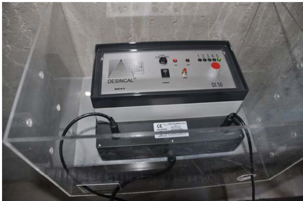
Desincal Serie DI-50 Aplicado sobre tubería de 120 mm Ø, para protección red municipal de 1.200 habitantes
