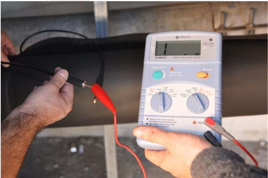
Comprobaciones de ausencia de conductividad en los electrodos.
