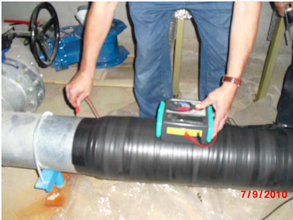
Comprobaciones de ausencia de conductividad en los electrodos.
