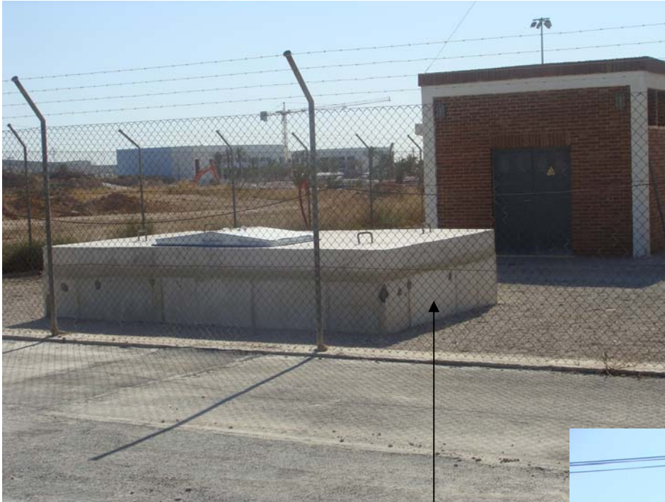
Arqueta protectora de la intemperie en la que se instala el equipo
