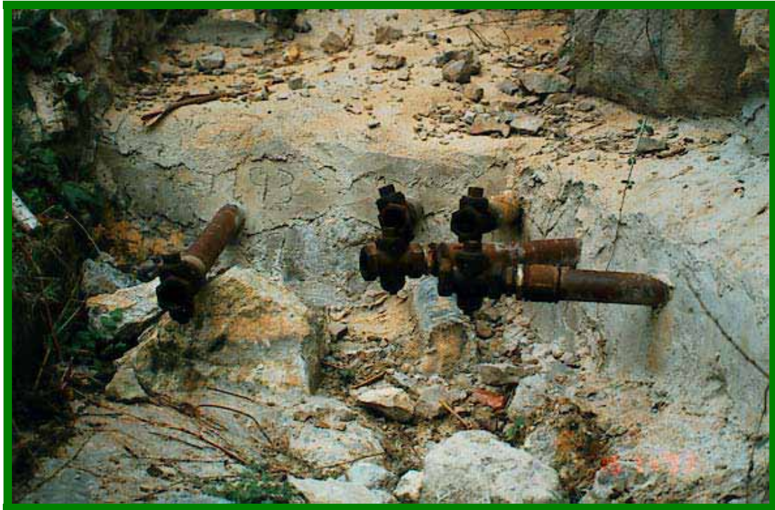
FOTO 15. Reconducción de la filtración
