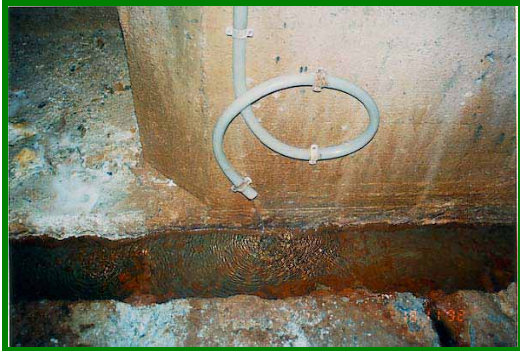
FOTO 3. Sifón para evitar la circulación de agua
