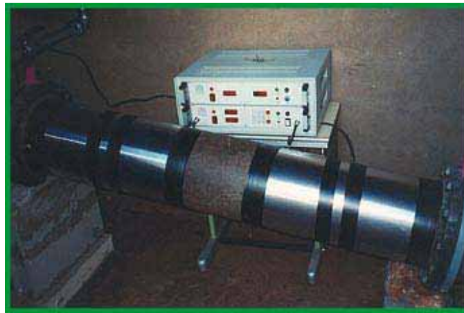
Instalación modelo DESINCAL DI-100 en el Municipio de FERRERIAS (Menorca), en funcionamiento desde 1994.
